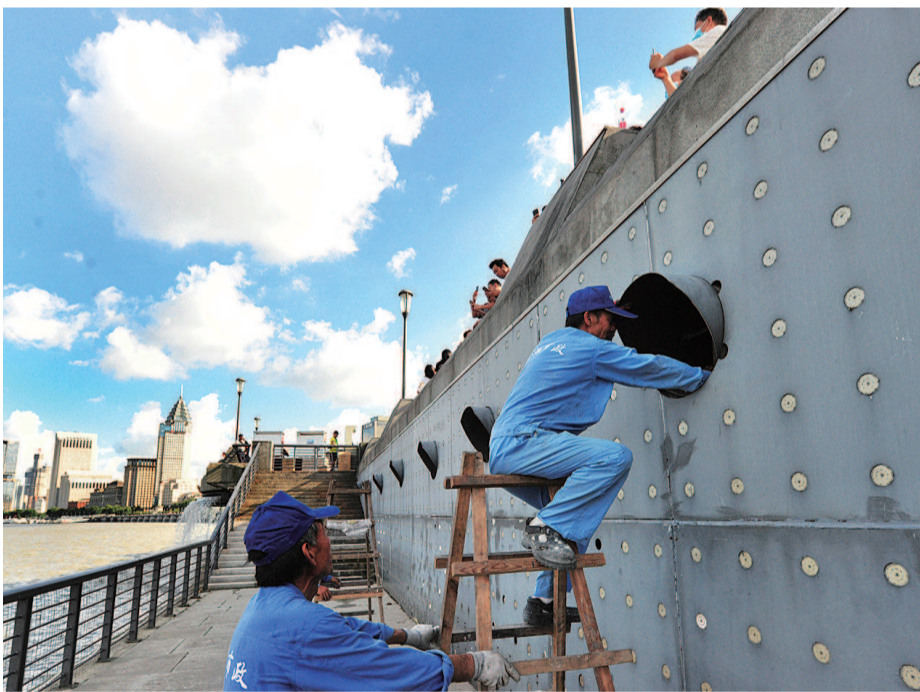
■ 申城各级防汛部门已经纷纷行动起来,落实有效举措及时排除安全隐患,严防以待战台风。在外滩风景区,防汛人员趁着退潮之际检查亲水平台箱席下的沿江舷窗是否关闭,确保不产生潮水倒灌现象 杨建正 摄影报道
