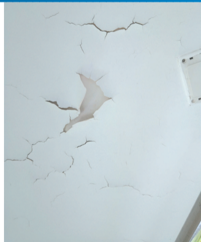
■ 装修后之久,顾女士的房屋出现裂缝 市民供图
