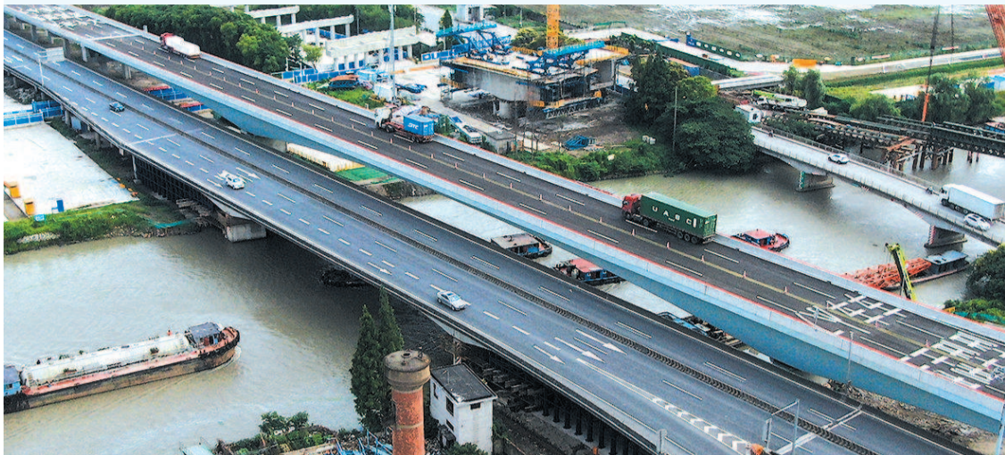
新建的吴淞江 G1503 高速公路桥西半幅净空提升至 7 米(右侧较高的是新桥)
