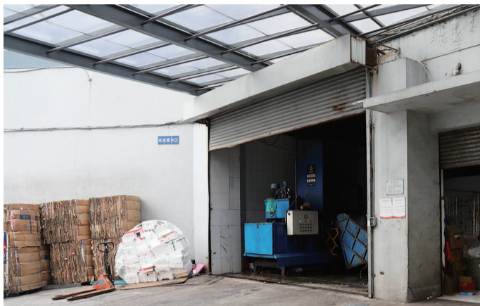
■ 垃圾箱房紧邻居民区,新的隔音屏障正在搭建 本报记者 王凯 摄
