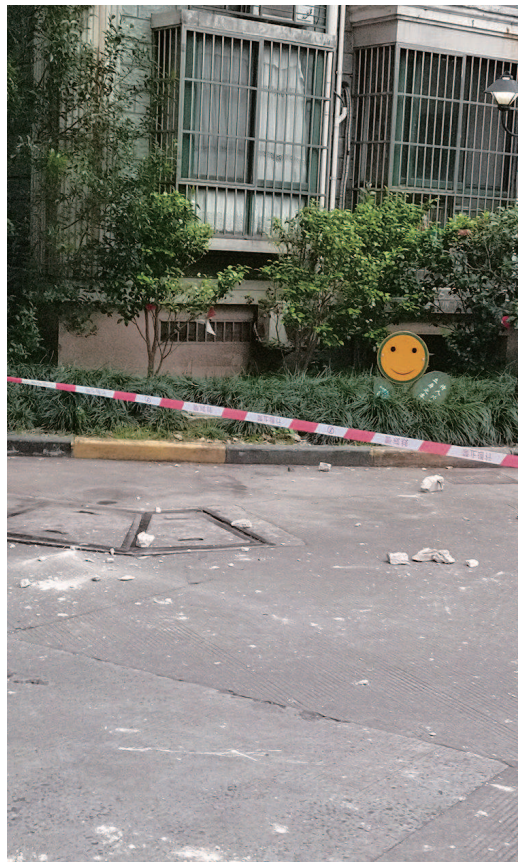
外墙装饰条掉落一地,周边拉起警戒线
