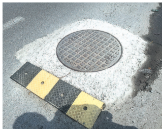
窨井盖高出路面5厘米
