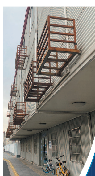
空调铁架锈迹斑斑
