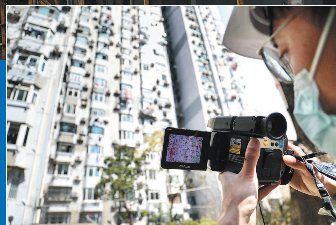
■ 上海房屋质量检测站工作人员检查西凌新邨外墙空鼓情况
