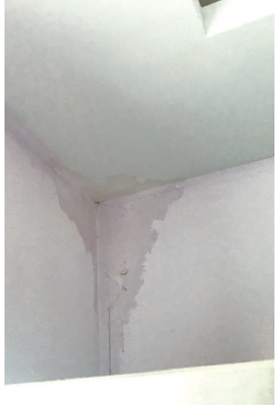
图四:渗水严重的屋顶一角
