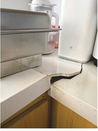
图三:开裂变形的厨房台面
