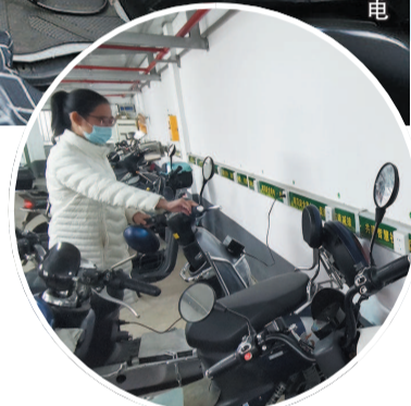
五里桥路210弄车棚内充电装置完备
