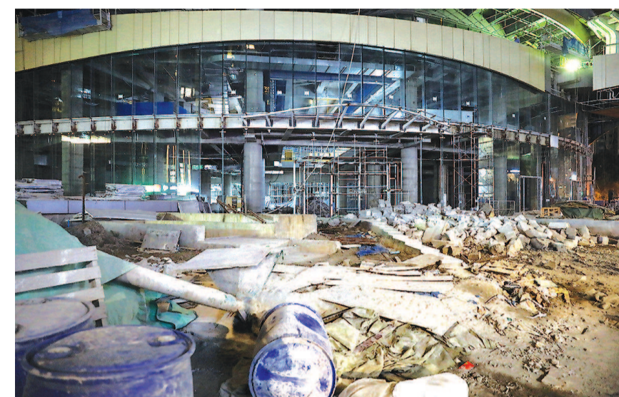
■ 工地现场垃圾裸露堆放,未覆盖绿网
