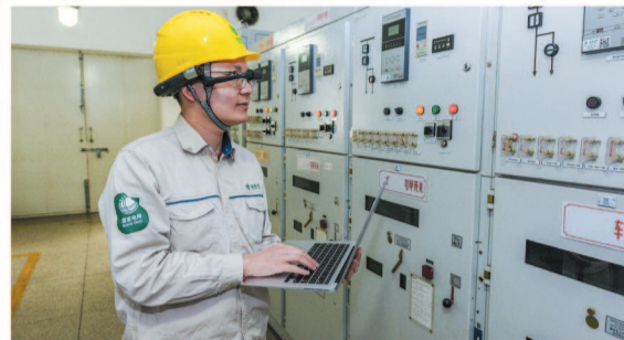
▲ 进博会前夕,国网上海电力变电运维人员使用“5G+AR+北斗单兵系统”对变电站设备进行巡视
