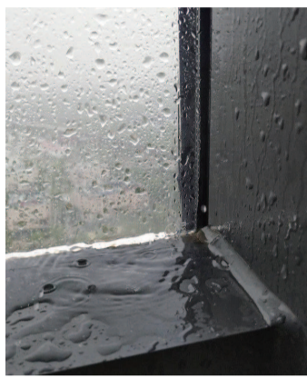
■ 海伦堡广场幕墙渗漏
