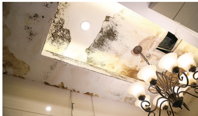
■ 虹桥万科润园14号楼1层公共区域屋顶发霉 本报记者 王凯 摄
