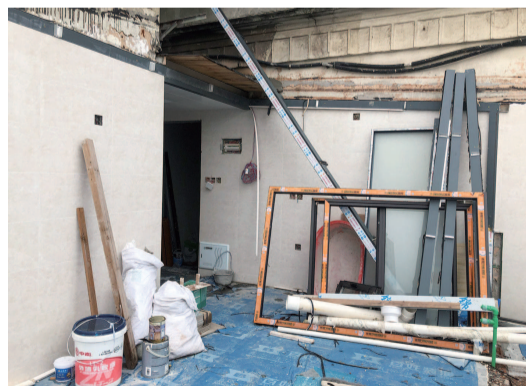
露台上窗根、水管等堆了一地 记者 王凯 实习生 钱臻 摄
