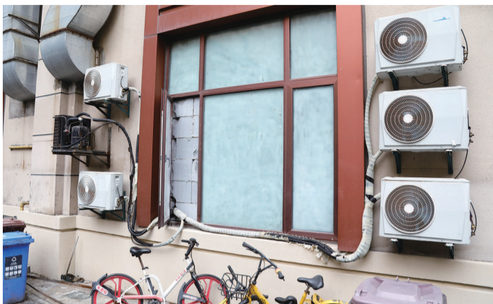
■ 恒高路128弄小区旁边的品膳坊饭店外墙上,外装的5台空调室外机和1台冰台室外机噪声扰民 本报记者 王凯 摄
