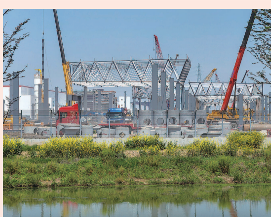
■ 4月7日，位于临港的特斯拉超级工厂二期工程已全面复工，进入钢结构顶棚吊装阶段
