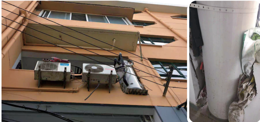
▲一眼望去，3楼公共走道北侧外墙与整幢大楼格格不入 ▲外墙破洞内塞满硬纸板等杂物 本报记者 季晟祯 摄
