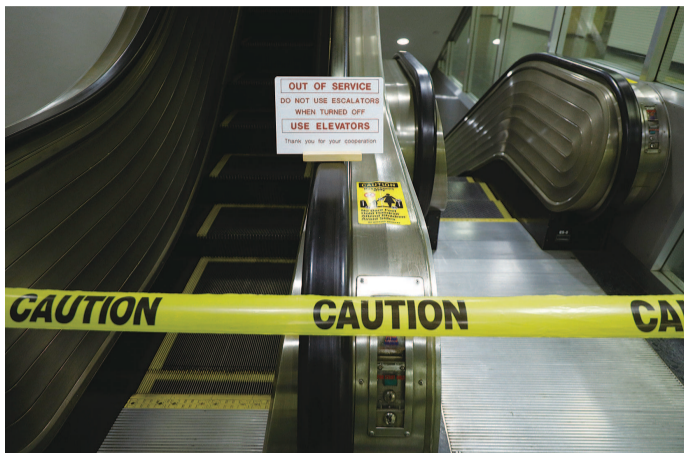
■ 联合国总部大楼内自动扶梯停运
