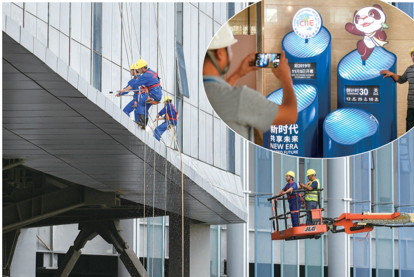
▲ 建筑工人在进博会倒计时装置前留影 ▲ 清洗国家会展中心外立面迎盛会 记者 陈梦泽 摄
