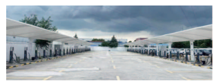
洞泾路29号的小桔松江工业区充电站的充电设施先进且安全可靠，能快速为车辆充电，日均接待车辆超过700台，为松江区的车主们提供了极大的便利。该站点全天有人值守，确保充电过
