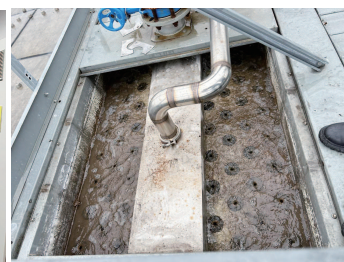
冷却塔布水器
