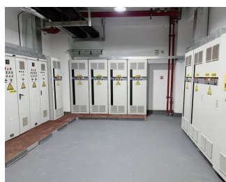
高效机房控制柜和变频控制柜
