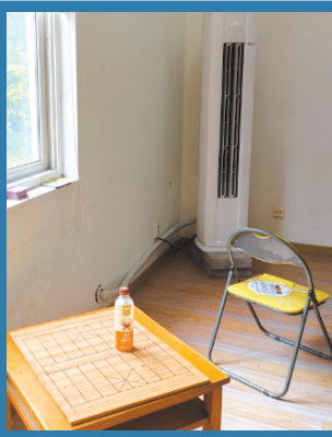
◀ 经居民们不断呼吁,小区活动室终于装上空调
