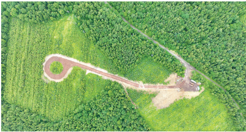
■ 长白山保护开发区林场内,射电望远镜项目开始施工建设
