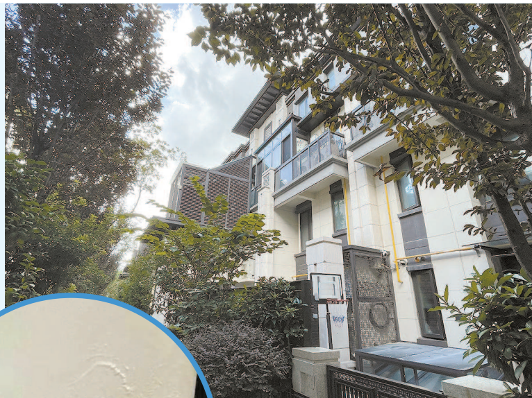
■ 漏水别墅外观
