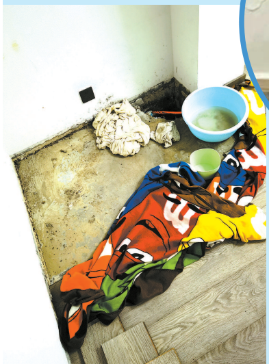
■ 漏水后家中一片狼藉
