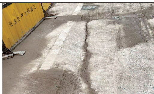
■ 小区路面开裂严重 陆常青 摄
