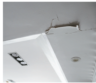
■ 天花板开裂亦无修补
