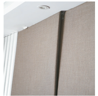
■ 长期渗漏致墙壁开裂、错位
