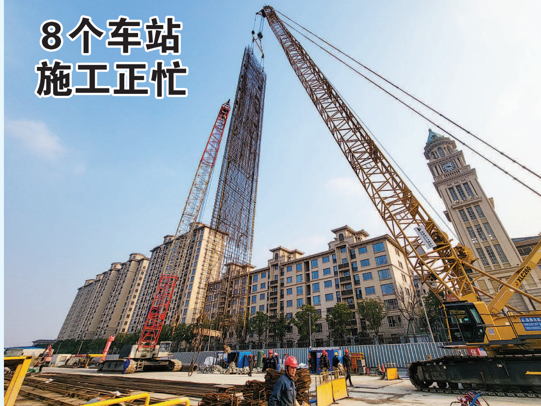
■ 在轨交21号线东靖路施工现场,吊机正将连续墙缓缓吊起,工程进度有序推进
