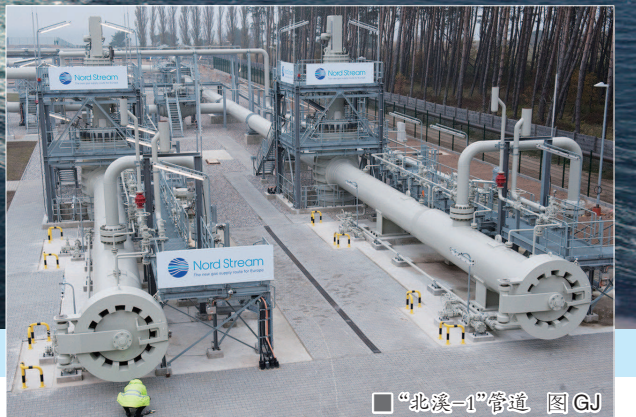
“北溪-1”管道 图 GJ
