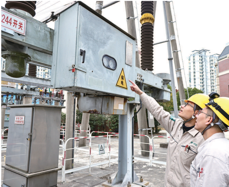
■ 国网上海市南供电公司工作人员巡视220千伏漕溪变电站
