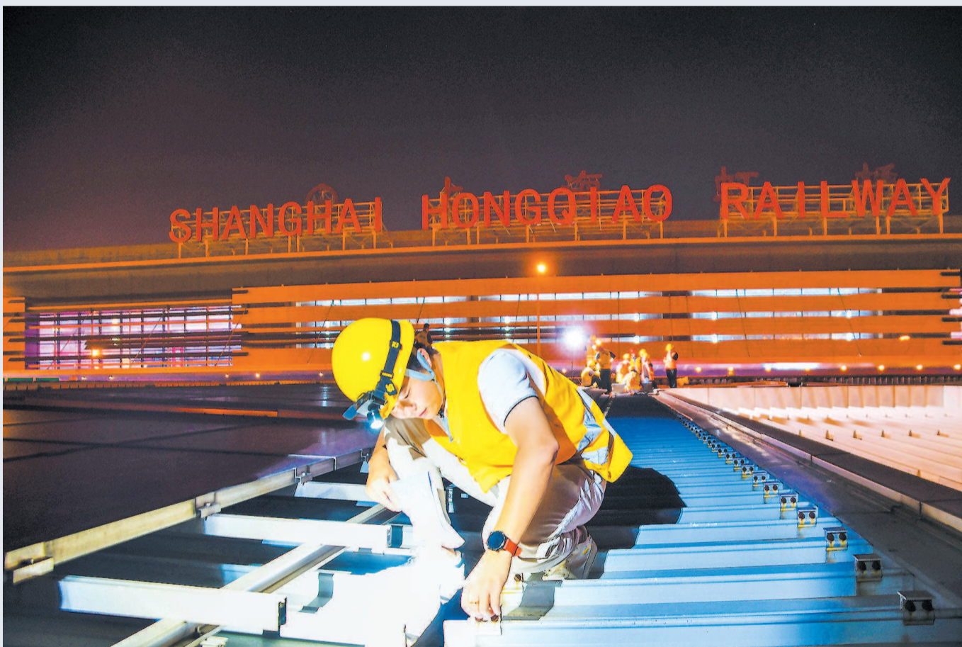
今天凌晨,在台风“烟花”来临之前,中国铁路上海局集团公司上海房建公寓段利用夜间“天窗”时间,替换破损雨棚屋面板,彻查铁路上海虹桥站雨棚漏雨问题,保障台风期间铁路运输安全 本报记者 陈梦泽 通讯员 李彩珍 摄
