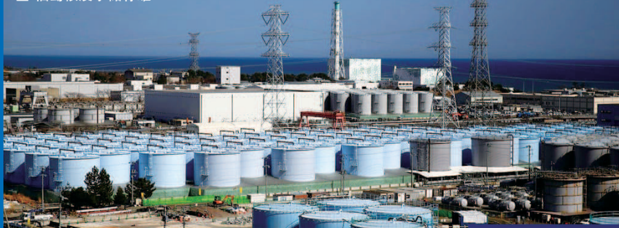
■ 福岛核废水储存罐
