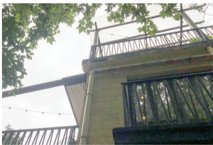
■ 汾阳路110号The Bull Claw 整足汇西餐厅在3楼搭出违法建筑 本报记者 王凯 实习生 钱臻 摄
