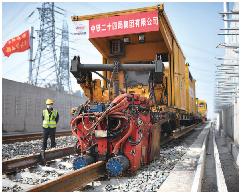
■ 轨交15号线锦秋路站至顾村公园站区间进行无缝线路焊轨作业 本报记者 陈梦泽 摄
